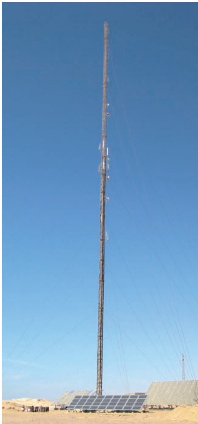
配备太阳能供电系统的基站
